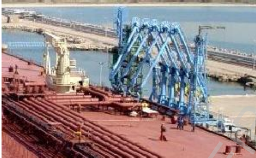
Φωτό: Βραχίονες φόρτωσης γημικών υγρών ουσιών
