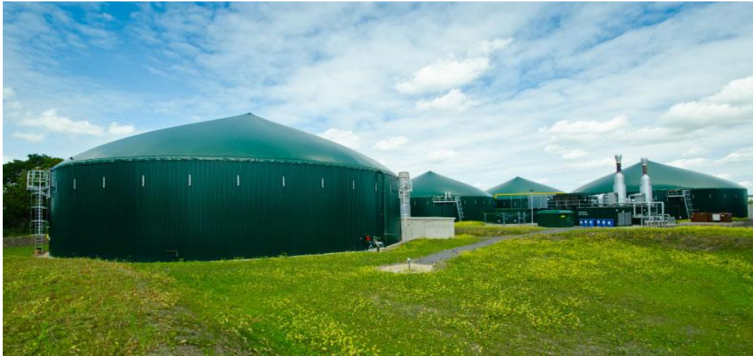
Σχήμα 1. Εγκαταστάσεις Αναερόβιας Χώνευσης και Αναβάθμισης Βιοαερίου, Cape Town ( http://www.fge.co )
