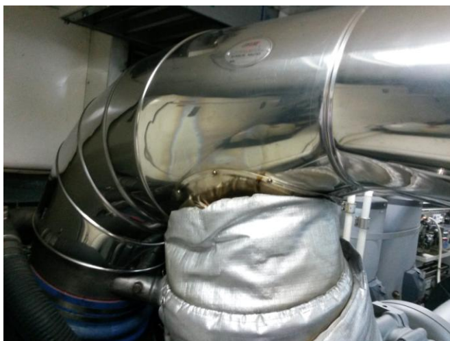
Εικόνα 8 - Εξατμίσεις σε μηχανοστάσιο σκάφους
