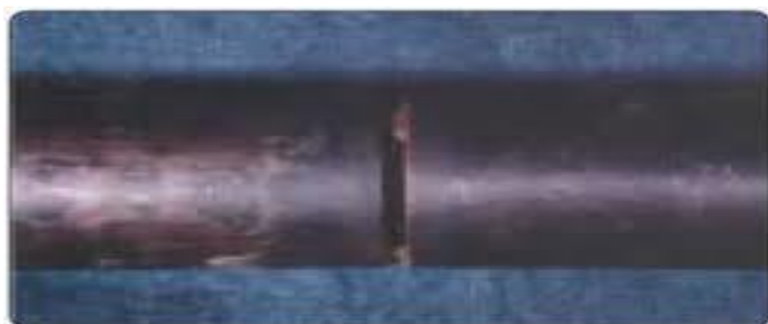
Εικόνα 4 – Βλάβη από Δόνηση στις σωληνώσεις
