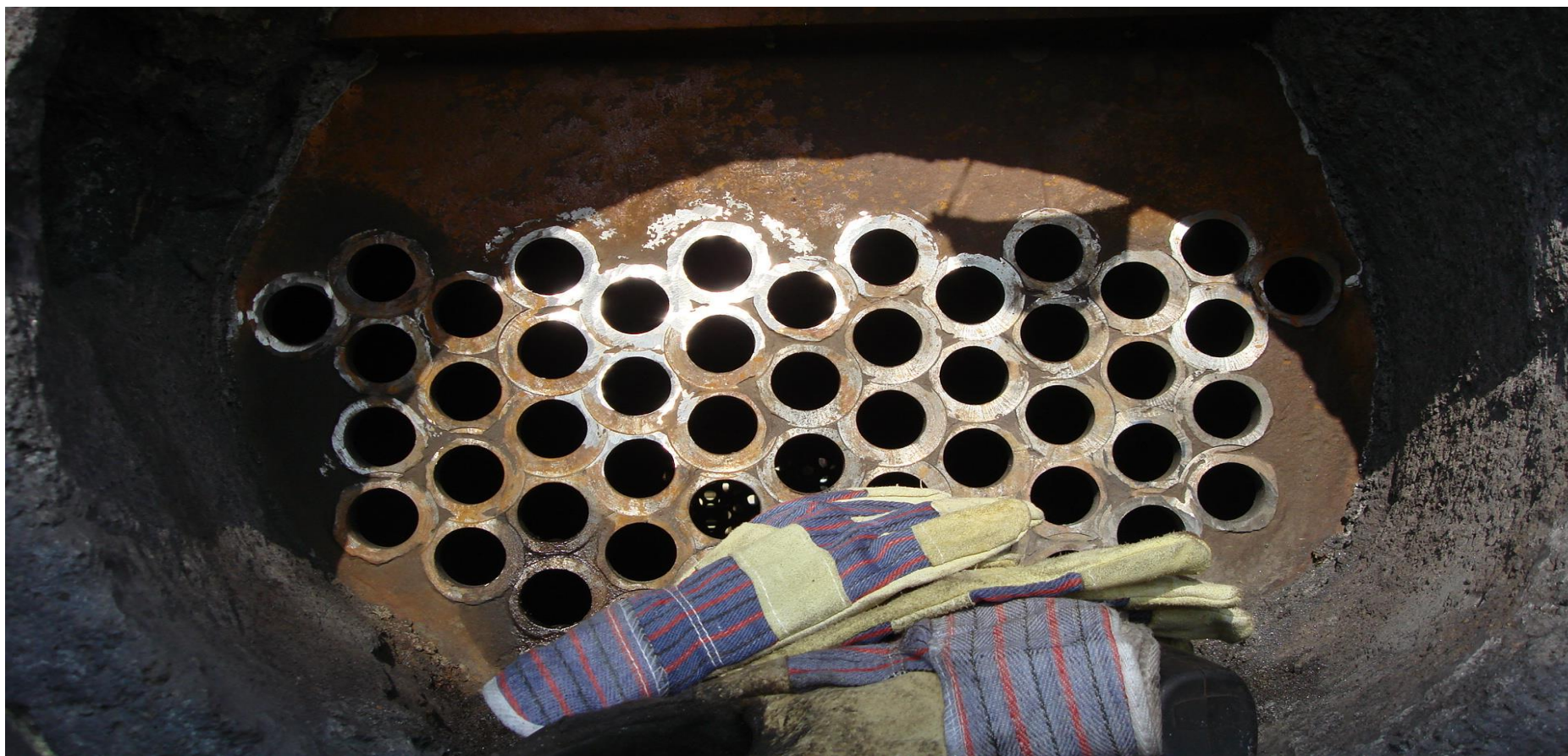
Εικόνα 10 – Καθρέφτης του Εναλλάκτη πριν την Ανατούμωση
