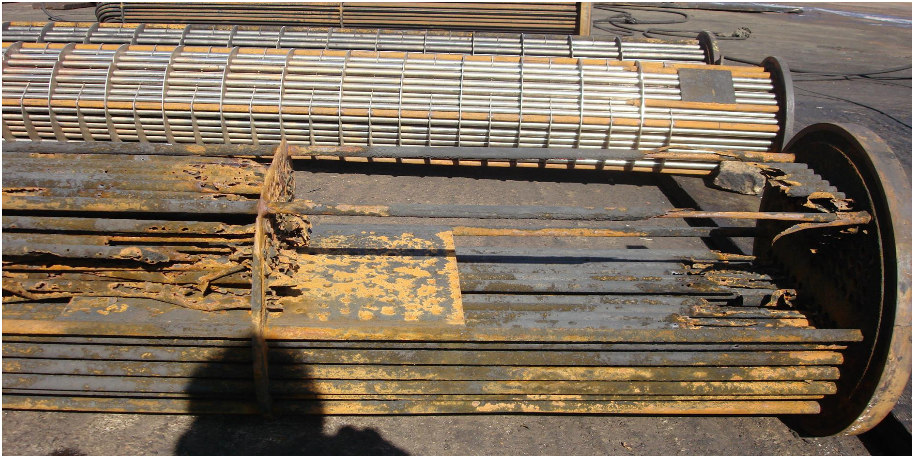
Εικόνα 16 – Διαβρωμένο Τουμποστοιχείο Εναλλάκτη (πίσω βρίσκεται το καινούργιο)
