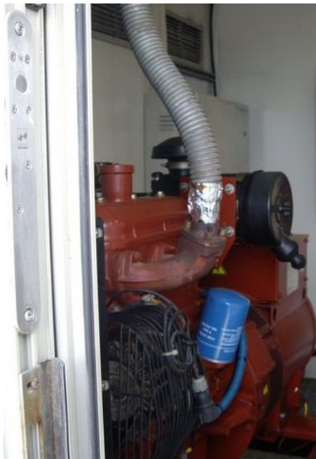
Σχήμα 12: Γεννήτρια σε σταθμό βάσης
