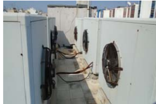
Εικόνα 7: Αντλίες Θερμότητας Οροφής
