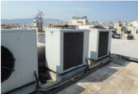
Εικόνα 6: Αντλίες Θερμότητας Οροφής
