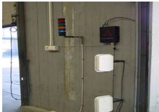
Εικόνα 4.3 Εγκατάσταση σε σημείο φόρτωσης αποθήκης
