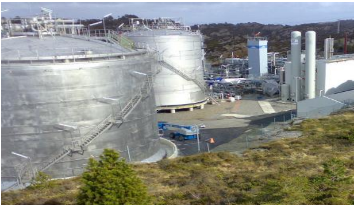
Εικόνα 6: Ατμοσφαιρικές Δεξαμενές LNG, χωρητικότητας 4000m 3 και 2000 m 3 αντίστοιχα, στην πόλη Kollsnes της Νορβηγίας
