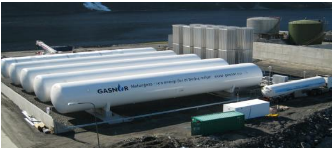
Εικόνα 5: Τερματικός Σταθμός LNG στο Mosjoen της Νορβηγίας.(5x683m 3 δεξαμενές συμπίεσης)
