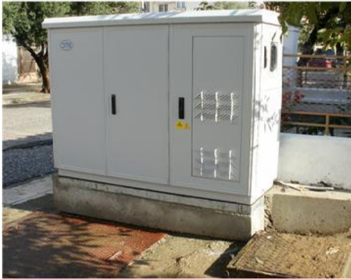
Εικόνα 16 : Καμπίνα Γ2R με το ενεργό εξοπλισμό στα δεξιά
