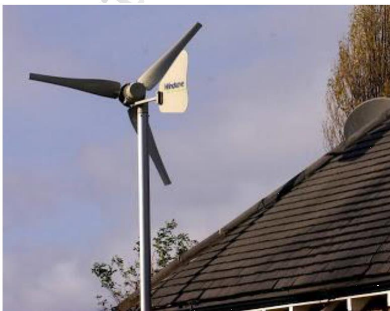
Φωτογραφία 3.3: Μικρή ανεμογεννήτρια εγκατεστημένη σε στέγη
