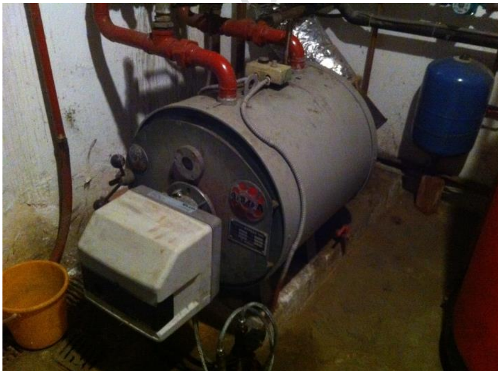
Φωτογραφία 7.3: Καυστήρας Πετρελαίου
