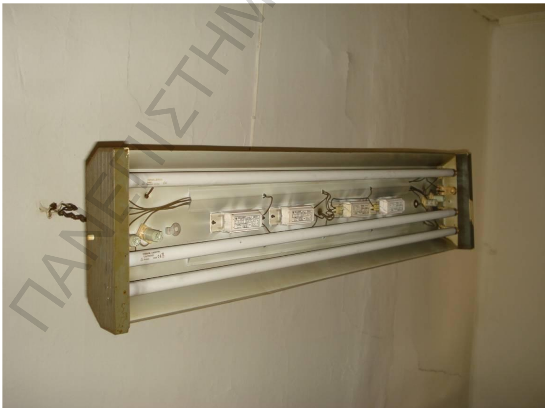
Φωτογραφία 5 Χώρος γραφείου – υφιστάμενο φωτιστικό σώμα
