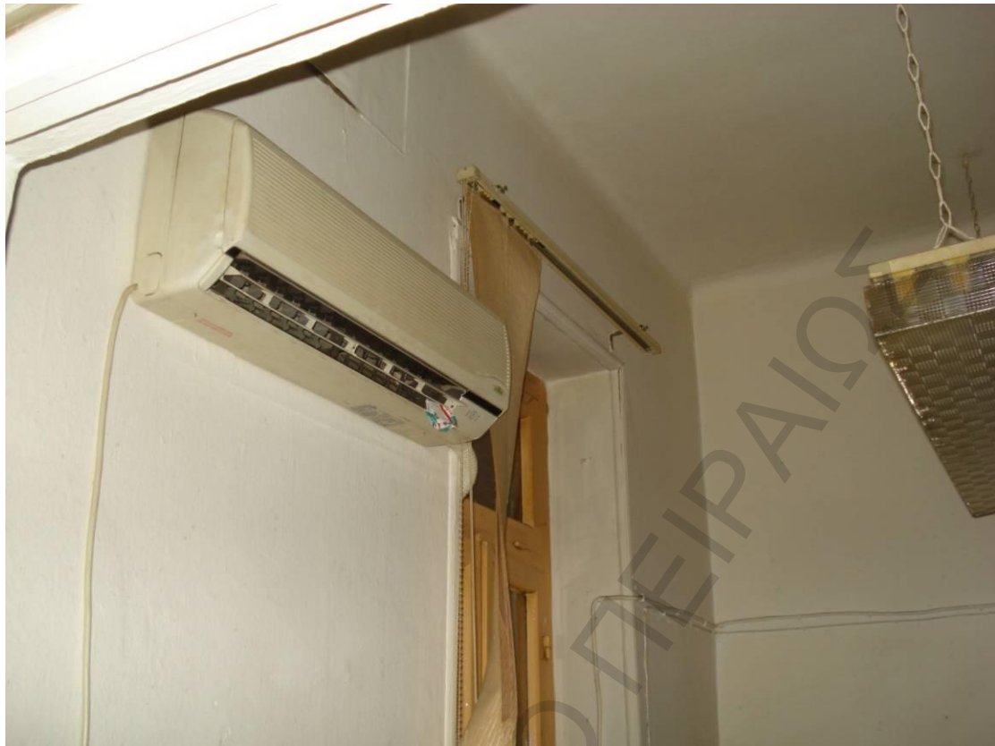
Φωτογραφία 4 Χώρος γραφείου – υφιστάμενη κλιματιστική συσκευή
