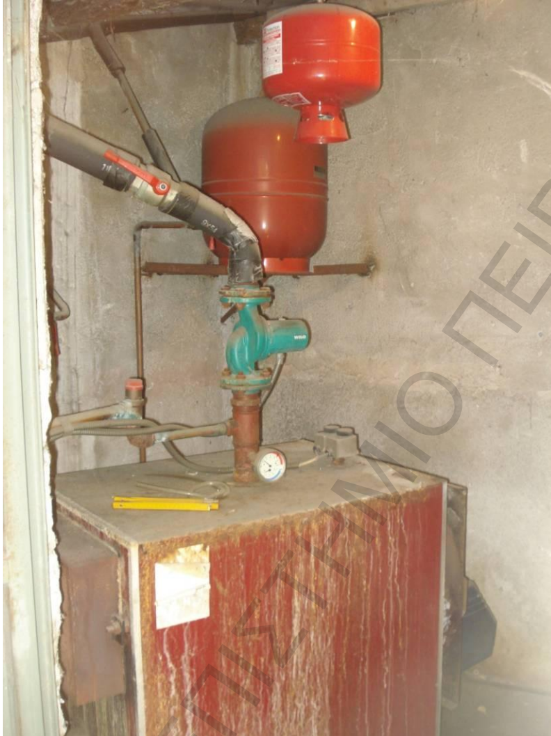
Φωτογραφία 3 Λεβητοστάσιο κτιρίου – πεπαλαιωμένες εγκαταστάσεις Κεντρικής Θέρμανσης
