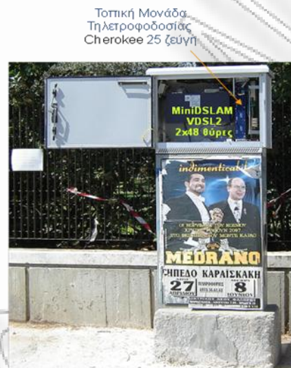
Εγκατάσταση miniDSLAM VDSL2 (V-BOX) σε υφιστάμενο ΚV του ΔΜ
