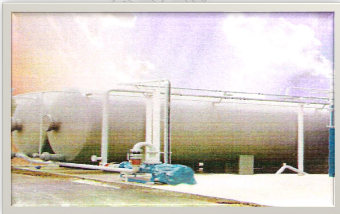
Εικόνα 5: Δεξαμενές αποθήκευσης γλυκερίνης
