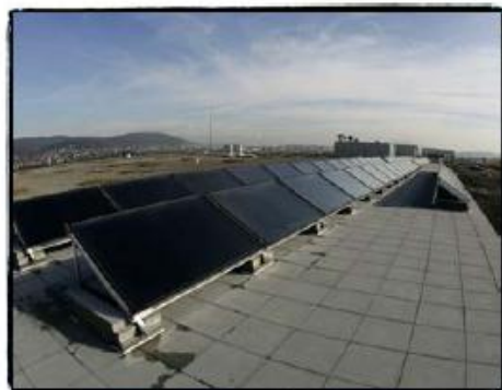
Σχήμα 29. Ηλιακοί συλλέκτες σε κατάστημα IKEA στην Ελβετία [2-35]
