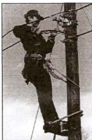
Σχήμα 17.4 :Μόνιμη εγκατάσταση οπτικών ινών πάνω σε στύλο
