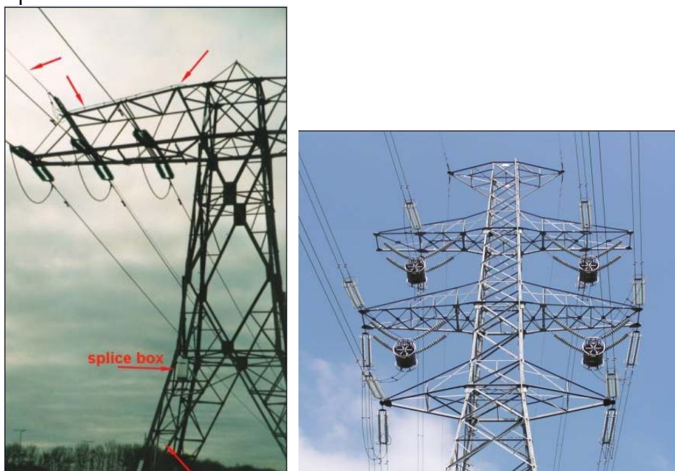
Σχήμα 17.8 :πυλώνας υψηλής τάσης
