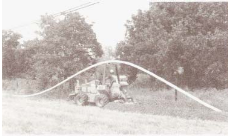
Σχήμα 9.1. Σε εγκαταστάσεις εξωτερικών χώρων, τα καλώδια οπτικών ινών συνήθως τοποθετούνται μέσα σε σωληνωτούς οδηγούς.
