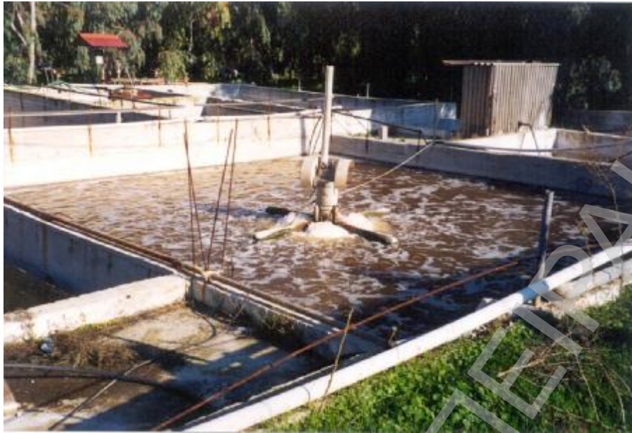
Εικόνα 1.23: Αερόβια δεξαμενή επεξεργασίας υγρών αποβλήτων της ΒΕΚΑ. Πηγή: Ευγενική παραχώρηση κυρίου Φραγκουδάκη Α.
