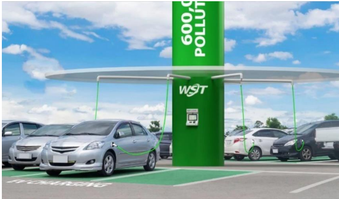
Εικόνα 27: Φόρτιση ηλεκτρικών οχημάτων στον οικολογικό σταθμό φόρτισης
