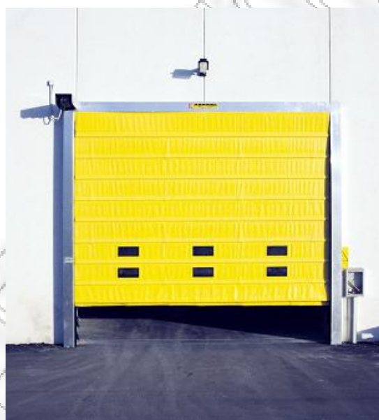
Σχήμα 38: Εξωτερική όψη πόρτας - ρολό
