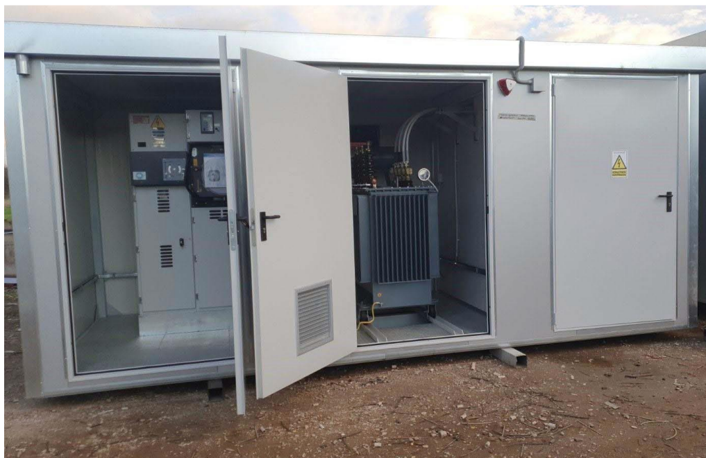
Εικόνα 4: Υποσταθμός τύπου κιόσκι του εν λόγω έργου
