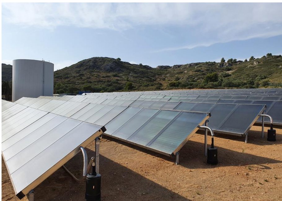
Εικόνα 1: Φωτοβολταϊκά σε σειρά (διάταξη strings)
