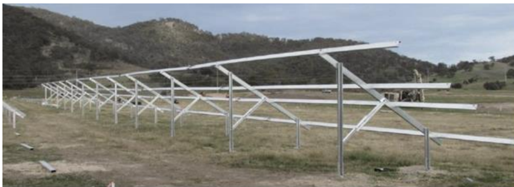
Εικόνα 10: Σύστημα στήριξης φωτοβολταϊκών
