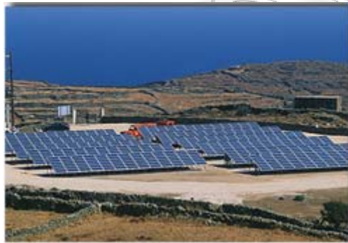
Εικόνα 13: Φωτοβολταϊκό σύστημα παραγωγής ενέργειας
