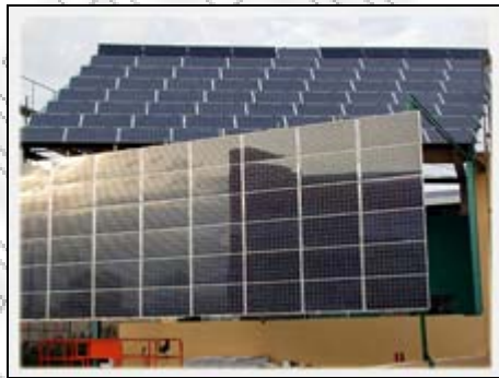
Εικόνα 12: Φωτοβολταϊκό σύστημα παραγωγής ενέργειας
