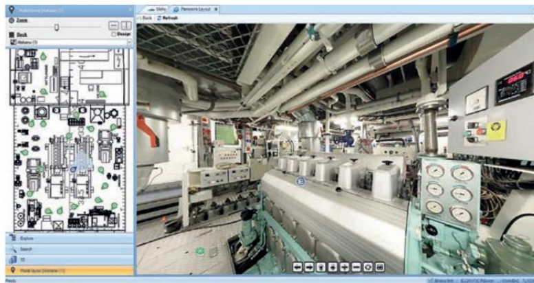
Εικόνα 66 - Άποψη του Μηχανοστασίου από το σύστημα EloWise
