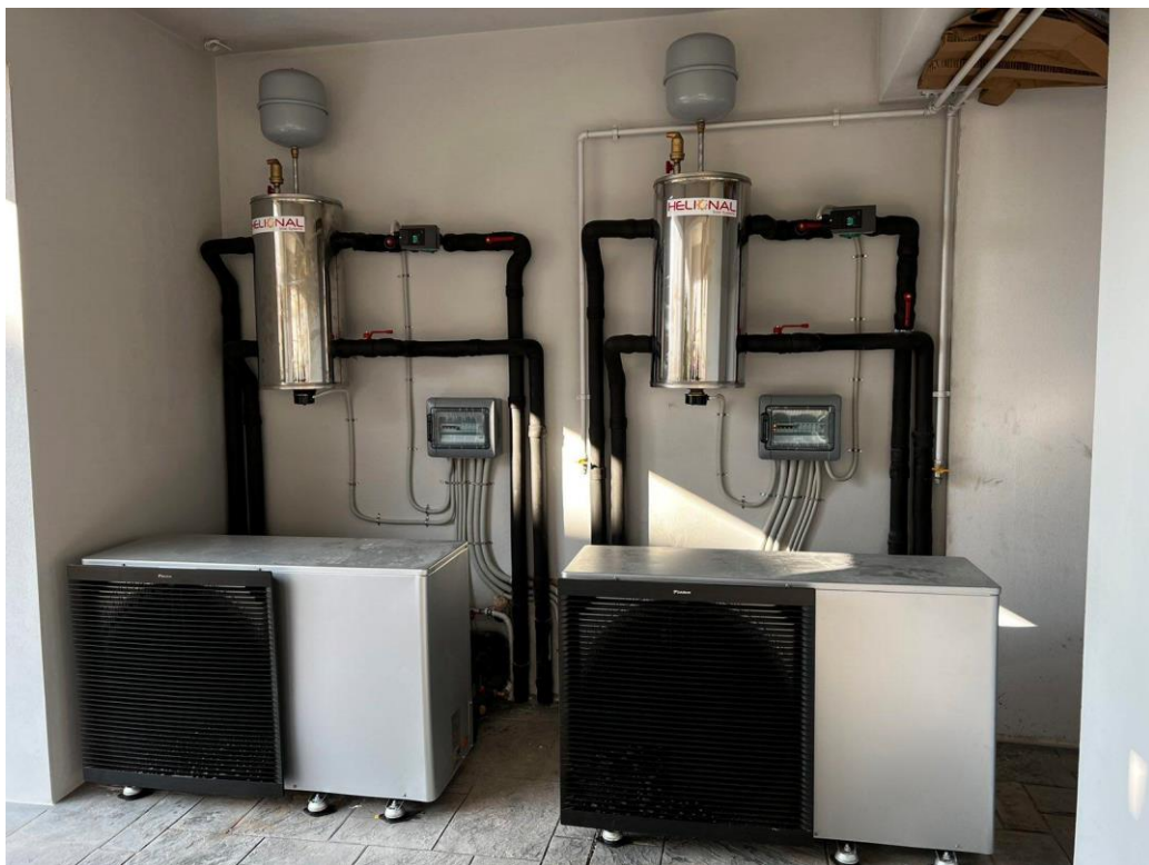
Εικόνα 9. Αντλίες θερμότητας σε νεόδμητο οίκημα
