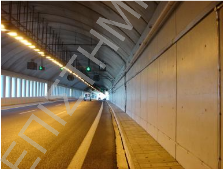
Πινακίδες Ελέγχου Λωρίδων Lane Control Signal (LCS) Πινακίδες Μεταβλητού Ορίου Ταχύτητας Variable Speed Limit Sign (VSLS)
