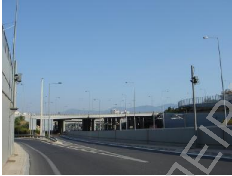
Διάταξη Ανίχνευσης Υπερβάλλοντος Ύψους Οχημάτων (OHVD)
