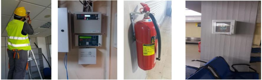
Εικόνα 16 : Βελτίωση της Πυρασφάλειας, Εγκατάσταση συστήματος συναγερμού πυρκαγιάς, Εγκατάσταση απινιδωτή, https://www.fraport-greece.com/
