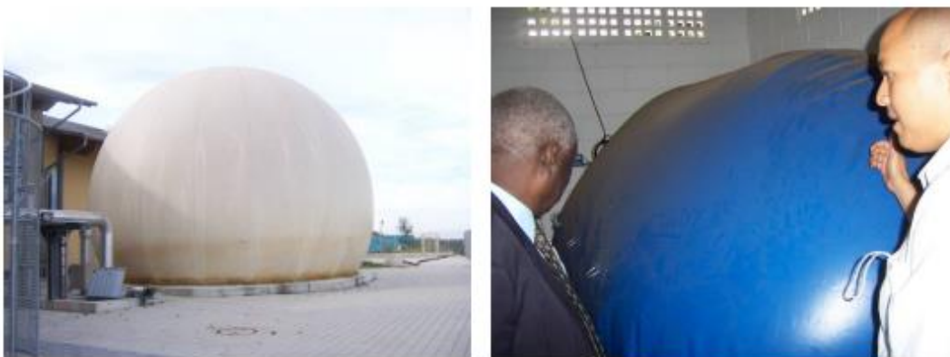
Φωτογραφία 4.5: Εξωτερικές δεξαμενές αποθήκευσης αερίου χαμηλής πίεσης
