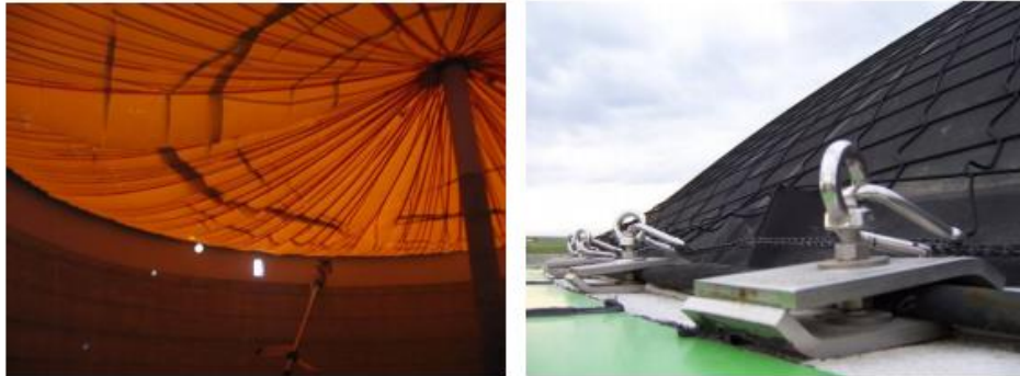
Φωτογραφία 4.6: Κάλυμμα χωνευτήρα από αεροστεγή μεμβράνη, όπως παρατηρείται από το εσωτερικό της δεξαμενής - αριστερά, εφοδιασμένο εξωτερικά με πλέγμα με πλέγμα διαστολής - δεξιά
