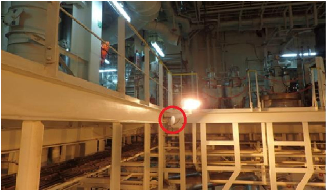
Εικόνα 34: Ασύρματο στο Μηχανοστάσιο
