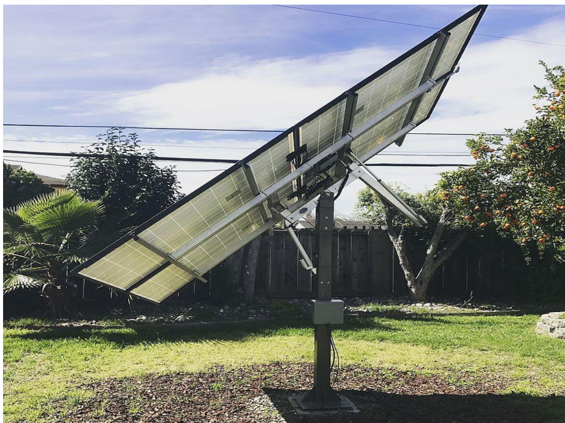
Εικόνα 3.3 Σύστημα παρακολούθησης ηλιακής ενέργειας
