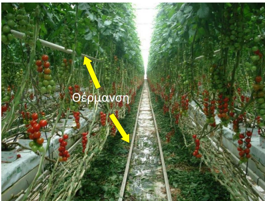
Εικόνα 4 Σωληνώσεις προσαγωγής ζεστού νερού συστήματος θέρμανσης
