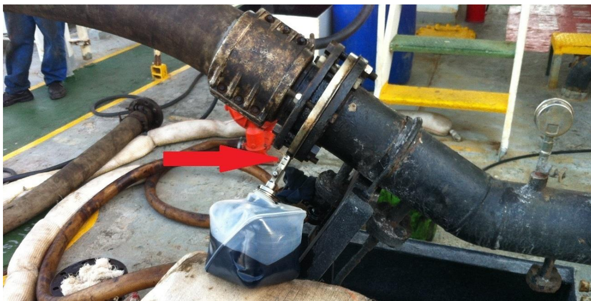
Εικόνα 2.16. : Φωτογραφία φορητού Continuous Drip Sampler εφαρμοσμένου μεταξύ Vessel's Bunker Manifold (Μαύρη σωλήνα δεξιά της σύνδεσης) και Bunker Delivery Hose (Μάνικα αριστερά της σύνδεσης). Εικόνα επίσημης διαδικασίας δειγματοληψίας που συναντάται στην πλειονότητα των πετρελεύσεων μέσω μπάριζας.
