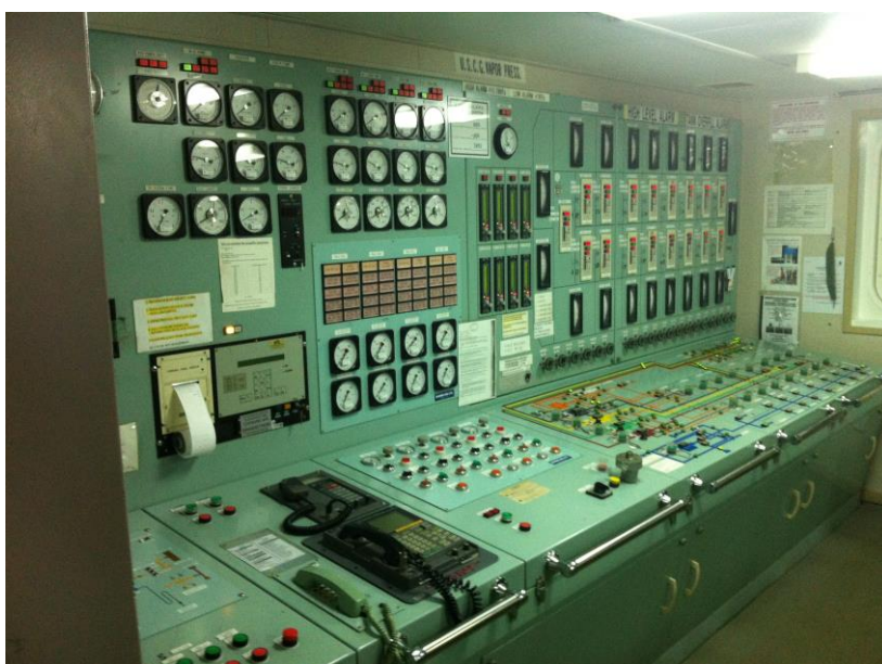
Εικόνα 2.13. Φωτογραφία ενός Cargo Control Room. Παρόμοιες εικόνες συναντάμε και σε ένα Engine Control Room.
