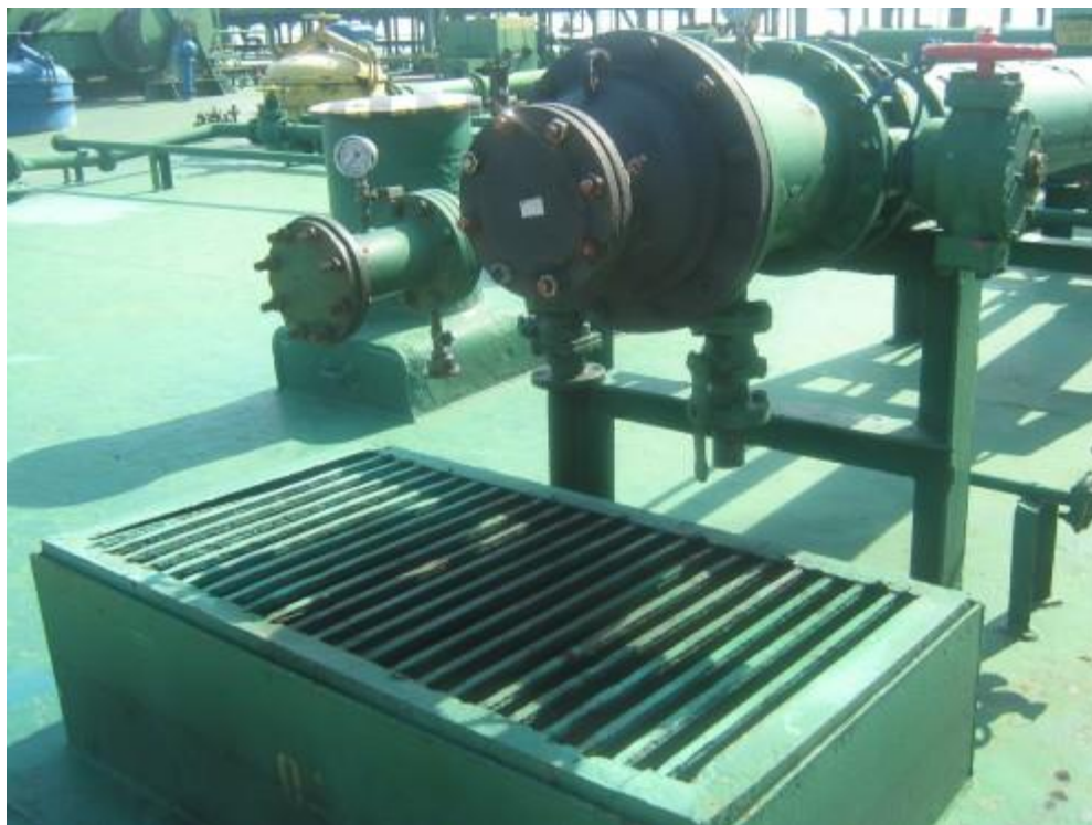
Εικόνα 2.5. : Bunker manifold για Diesel Oil (μικρής διατομής αριστερά) και για Fuel Oil (μεγάλης διατομής δεξιά με μαύρου χρώματος reducer).
