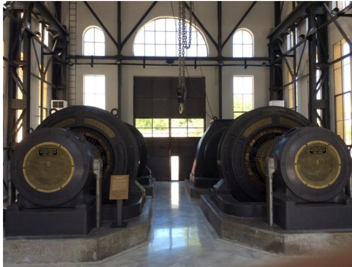
Εικόνα 4.9: Στρεφόμενοι μετατροπείς, ΑΗΣ Φαλήρου. Μετέτρεπαν το εναλλασσόμενο ρεύμα σε συνεχές και το διοχέτευαν στον παρακείμενο σιδηρόδρομο για τις ανάγκες κίνησής του. Πηγή: Από προσωπικό αρχείο
