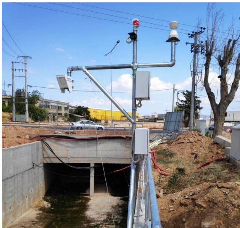
Εικόνα 2.1 Σύστημα έγκαιρης προειδοποίησης μετεωρολογικών και πλημμυρικών φαινομένων για τη λεκάνη Μάνδρας-Ελευσίνας της METRICA A.E.
