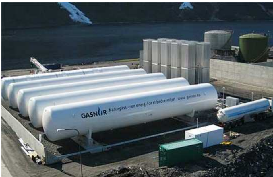
Εικόνα 10: Δεξαμενές LNG σε εγκατάσταση της εταιρίας Gasnor
