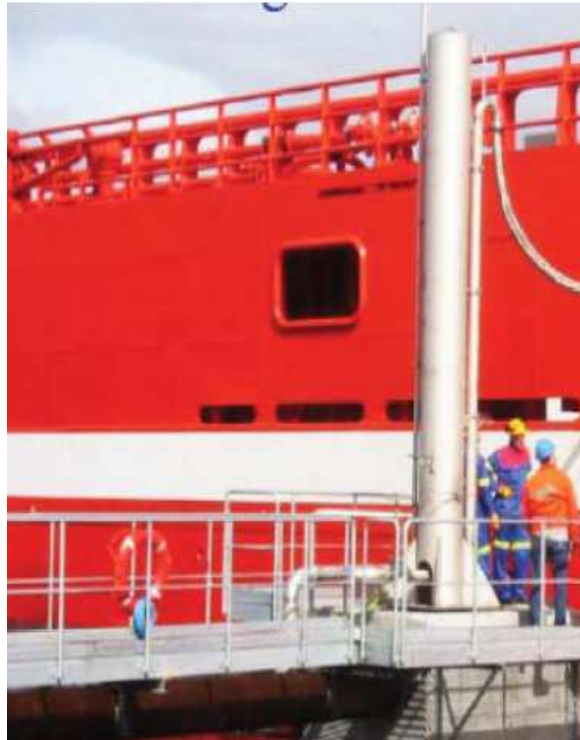
Εικόνα 11: Μάνικα σε προβλήτα μεταφοράς LNG από δεξαμενή
