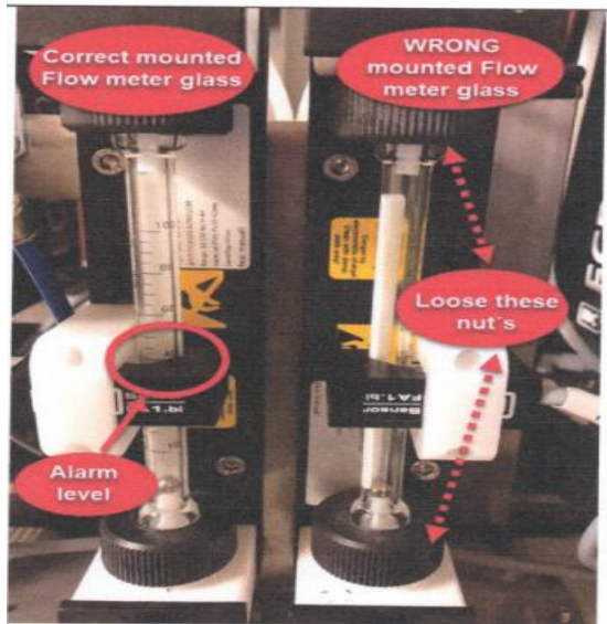
Εικόνα 16. Ηλεκτρονικό Σύστημα παρακολούθησης CO 2 /SO 2
