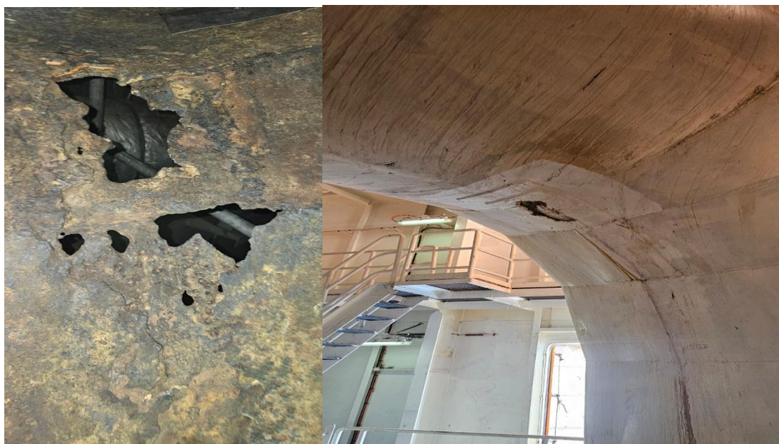
Εικόνα 29. Χαρακτηριστικό παράδειγμα διάβρωσης σωλήνα εξαγωγής καυσαερίων λόγω διοξειδίου του θείου.(Sox)
