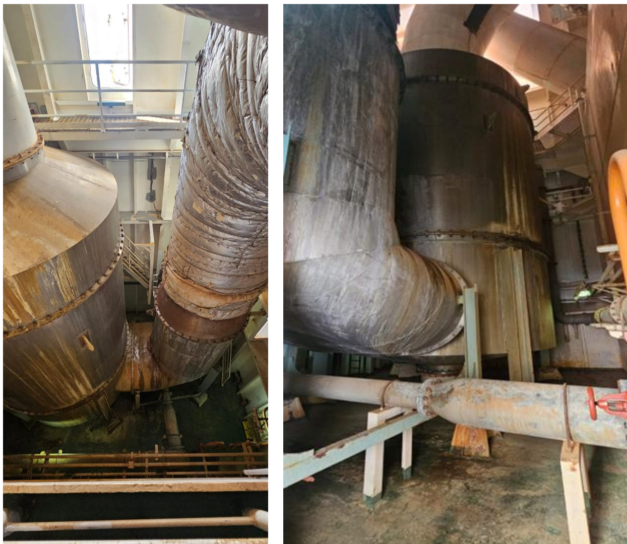
Εικόνα 18. Πλυντρίδα καυσαερίων με διαρροή καυσαερίων
