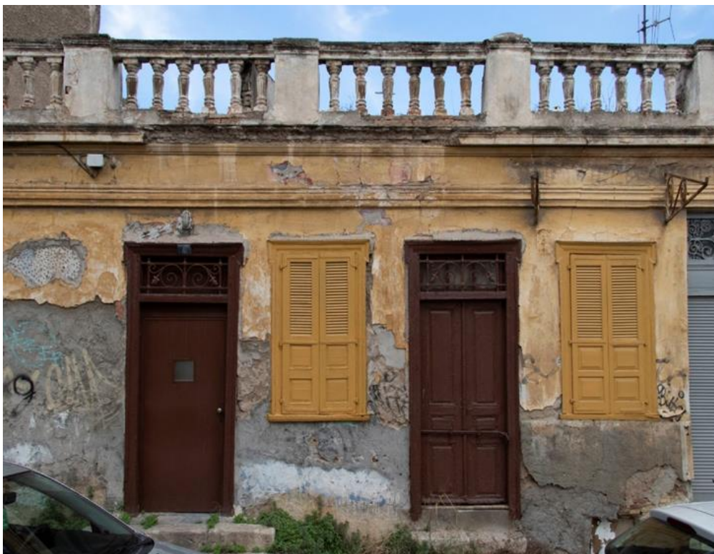
Εικόνα 4.10: Το κτίριο στη Φίλωνος 4. Ισόγειο κτίριο με εμφανείς φθορές. Στην όψη διακρίνονται ίχνη από τραβηχτά επιχρίσματα, ενώ στηθαίο στο δώμα κοσμεύεται με μπαλαούστρα
