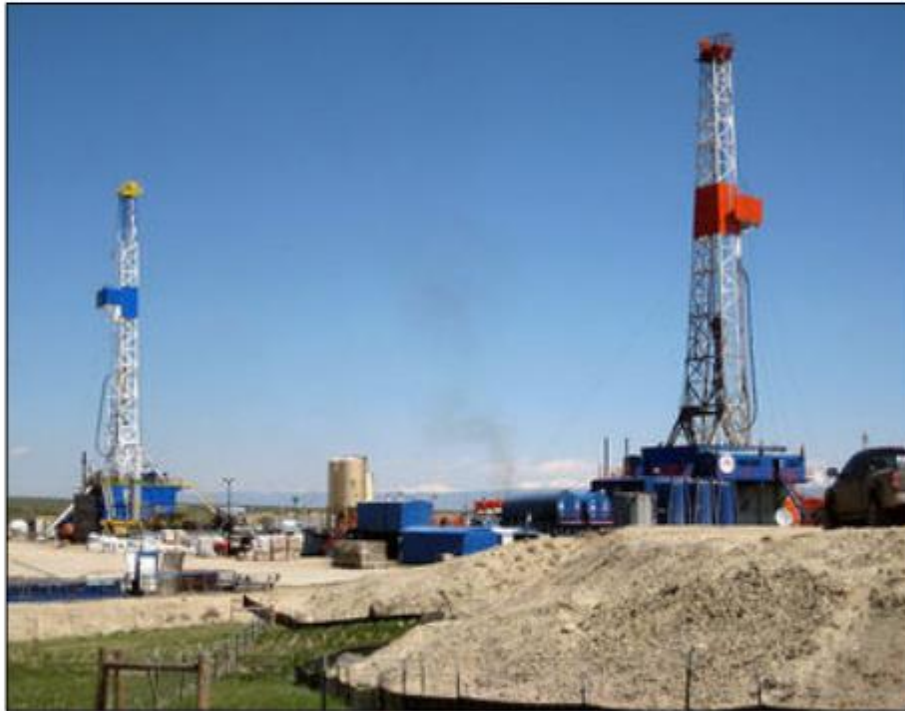
Εικόνα 8:Εγκαταστάσεις χερσαίας γεώτρησης. [36]
