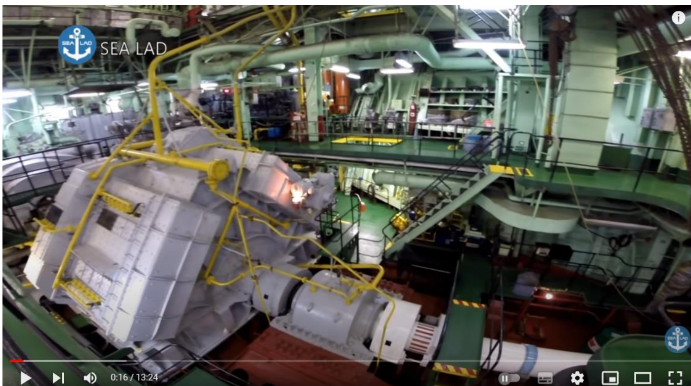
Εικόνα 39. Μηχανοστάσιο LNG πλοίου με ατμοστρόβιλο. Πηγή: Στιγμιότυπο από βίντεο περιήγησης σε μηχανοστάσιο. Steam Turbine - LNG Ship Engine Room (Video Tour) - YouTube (The Sea Land, 2019)
