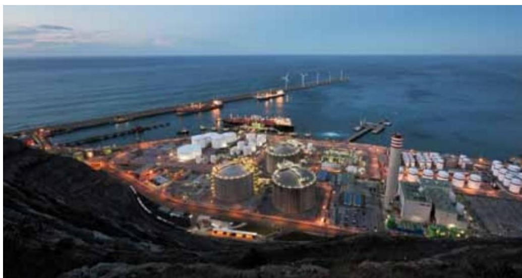
Εικόνα 9. Εγκατάσταση επαναεριοποίησης και αποθήκευσης στο Bilbao της Ισπανίας. Πηγή: IGU Magazine April - September 2020, Πηγή: April 2020 | IGU
