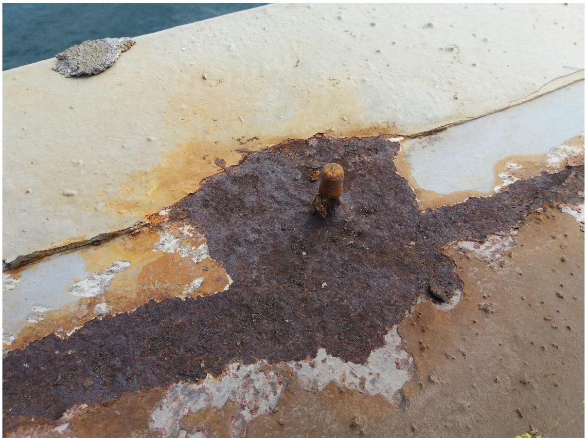
Εικόνα 21 : Περιοχή αμφικόχλιου, πλήρως διαβρωμένη περιφερειακά συγκόλλησής του στο κατάστρωμα.
