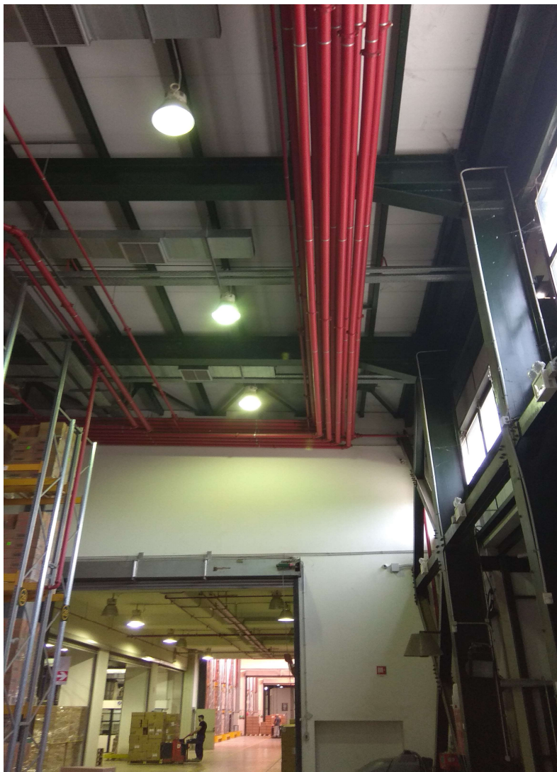
Εικόνα 2.4 (15) Εναέριοι σωλήνες μεταφοράς νερού
