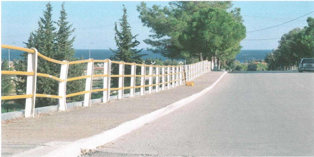
Εικόνα 12: Το βέλος κάμψης ορατό από το κυκλίδωμα της γέφυρας στο επίπεδο του καταστρώματος
