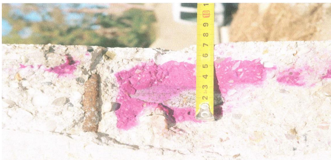
Εικόνα 15: Αλλαγή χρώματος του σκυροδέματος και οξείδωση του οπλισμού
