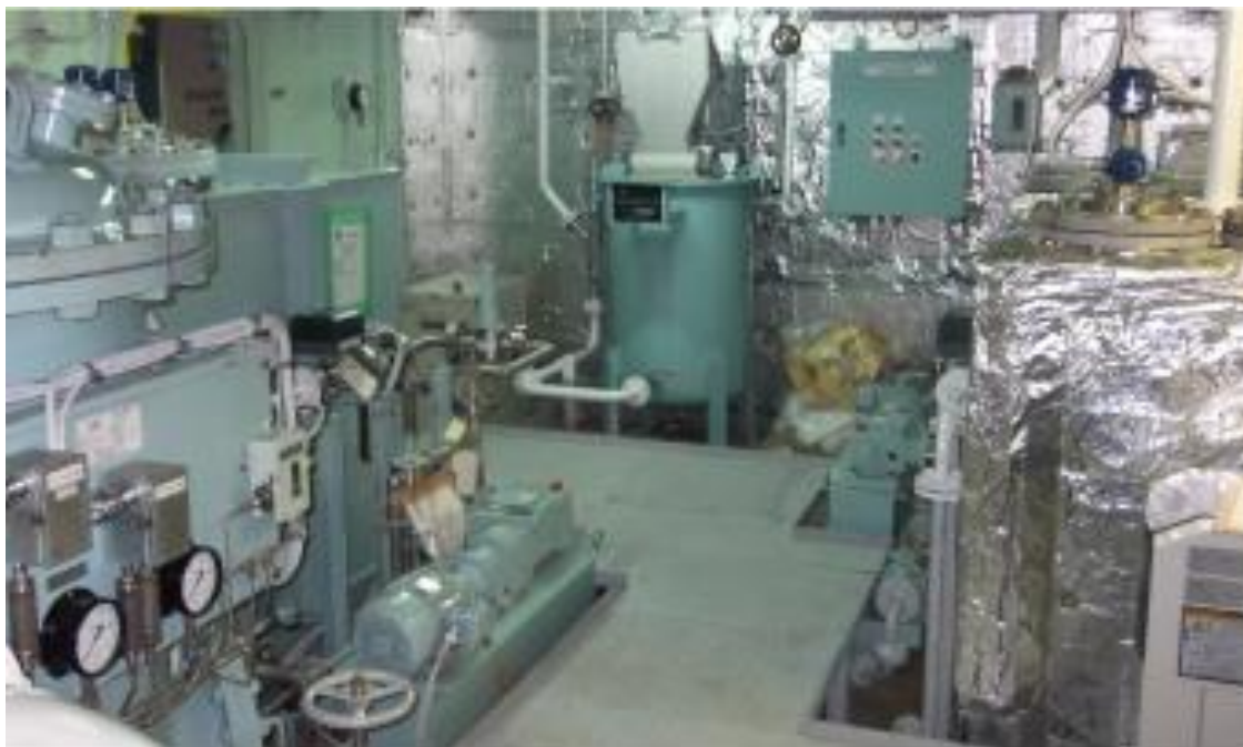
Εικόνα No.10: Σύστημα Ballastage
