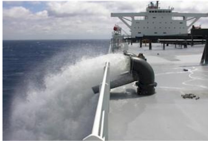
Εικόνα No.6: Ballast Discharging Manifold
