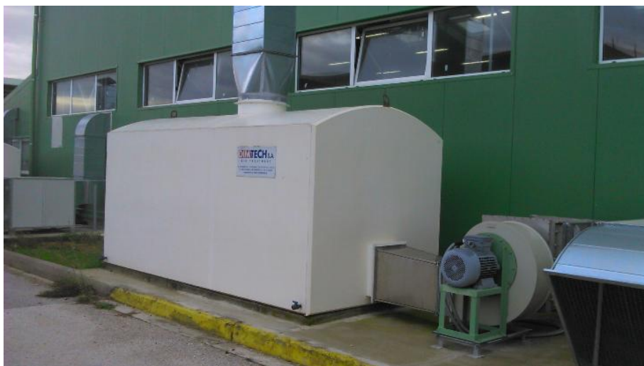
Εικόνα 4.6.: Σύστημα εξαερισμού συνεργείου επιμεταλλώσεων με ενεργό άνθρακα
