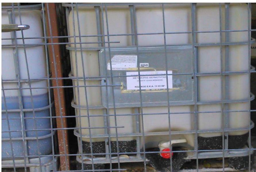
Εικόνα 4.8 : Δεξαμενή αποθήκευσης συνθετικών ελαίων μόνωσης και μεταφοράς θερμότητας
