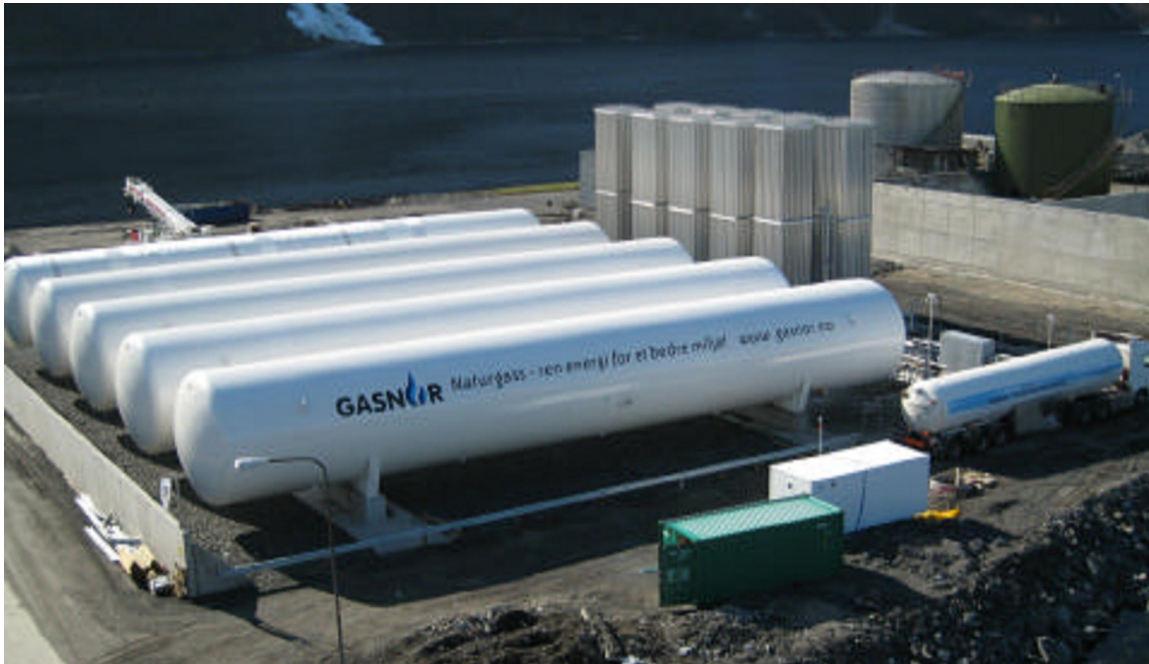
Εικόνα 4.1: Τερματικός Σταθμός LNG στο Mosjoen της Νορβηγίας (5x683m 3 δεξαμενές συμπίεσης)
