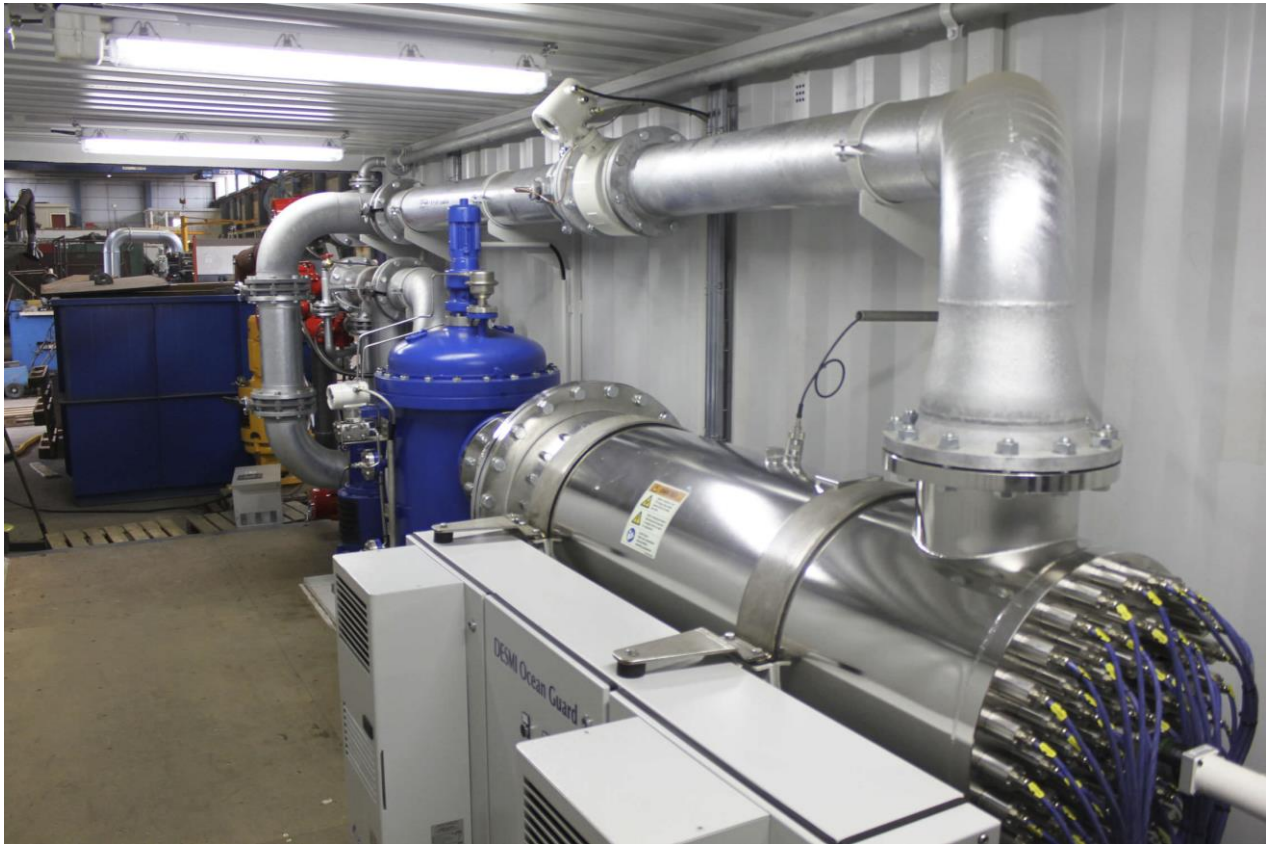
Εικόνα 5 Μονάδα επεξεργασίας θαλάσσιου έρματος
