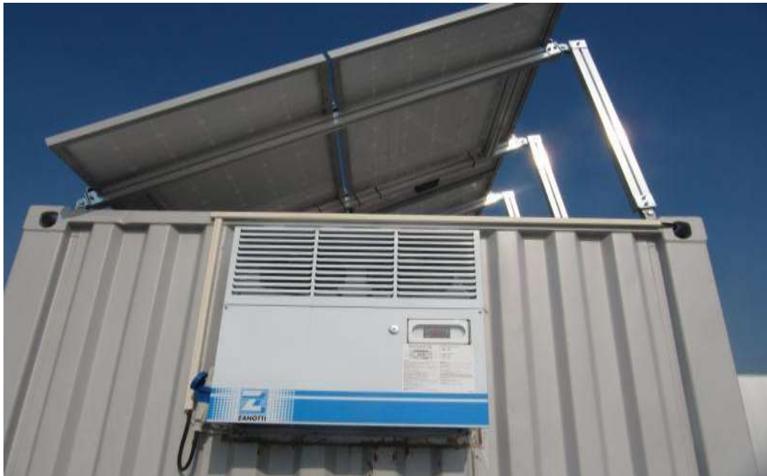
Container με φωτοβολταϊκά πάνελ.
