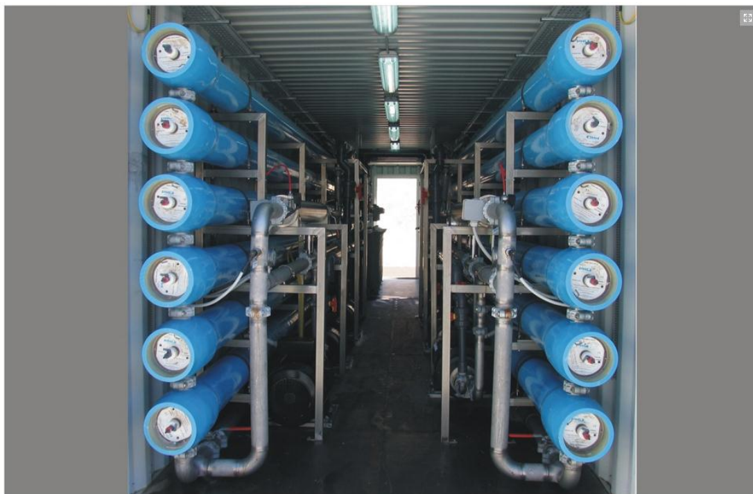
Εικόνα 2.4.1.: Μονάδα τοποθετημένη σε container
