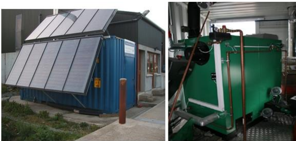
Εικόνα 4.1 Η Ενεργειακή Καμπίνα με τα ηλιοθερμικά πάνελ.
