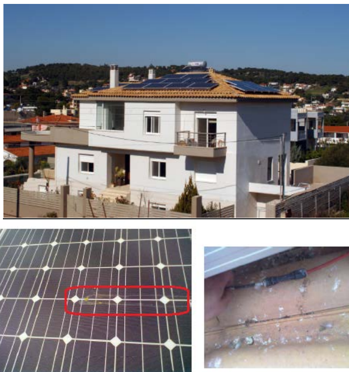
ΕΙΚΟΝΑ 4.10. Περιπτώματα πτηνών σε Φ/Β πλαίσιο Οικιακού συστήματος 5kWp (Πόρτο Ράφτη Αττικής, Δεκέμβριος 2010)
