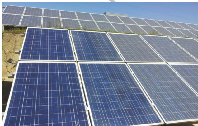
ΕΙΚΟΝΑ 4.13. Έλεγχος μείωσης απόδοσης λόγω σκόνης σε πολυκρυσταλλικά Φ/Β πλαίσια επίγειου Φ/Β συστήματος σε αγροτική περιοχή στην Εύβοια (Εύβοια, Απρίλιος-Μάιος 2013)
