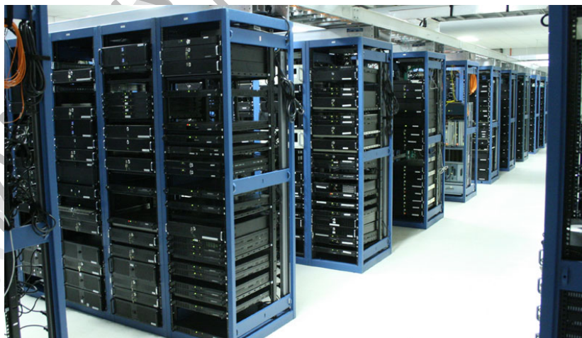
Εικόνα 1 Κέντρο Αποθήκευσης Δεδομένων-Data Center
