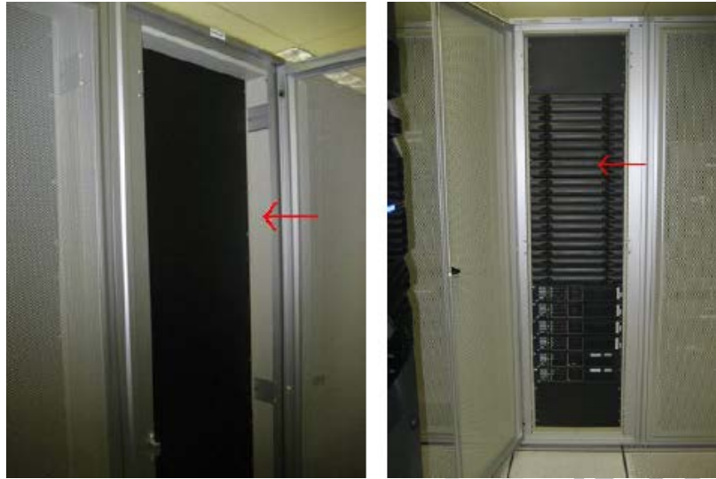
Εικόνα 24 Rack με τοποθετημένα εμπόδια διέλευσης αέρα
