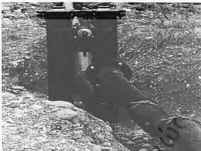
Φωτογραφία 2: Η διαμόρφωση κεφαλών φρεατίων όπου διακρίνεται το σύστημα προσαρμογής στις καθιζήσεις
