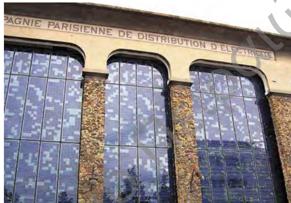
Εικόνα 12 Φωτοβολταικά κύτταρα τοποθετημένα στην όψη του ξενοδοχείου Industrial στο Παρίσι
