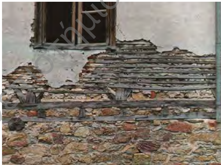
Εικόνα 2 Μπαγδατί με καρφωτές πήχεις & υποκείμενη αργολιθοδομή
